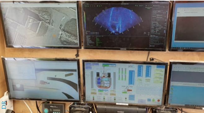
Contrôle commande de Lisie
